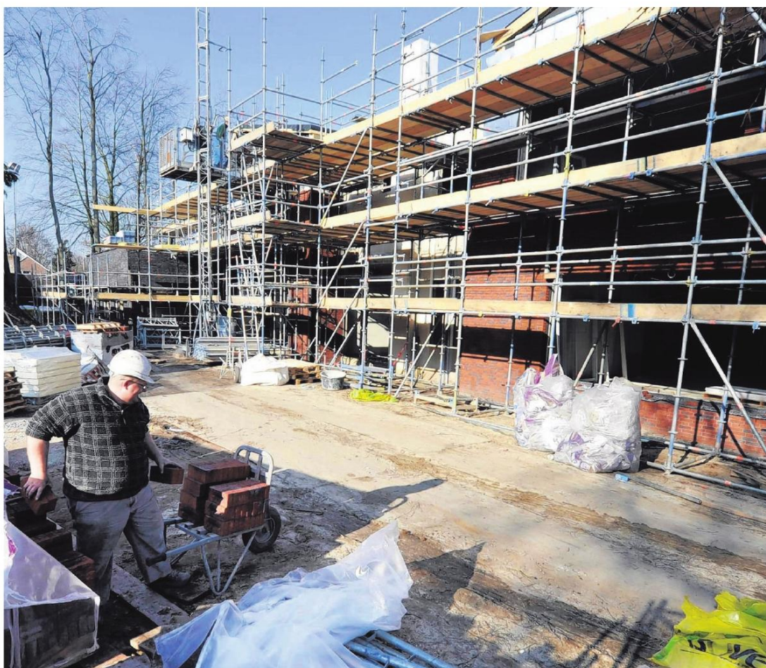
• Het kulturhus in Overdinkel nadert zijn hoogste punt, maar staat nog wel grotendeels in de steigers. Het werk aan de buitenwerk duurt naar verwachting nog een maand, daarna wordt begonnen met de binnenkant. foto Carlo ter Ellen
